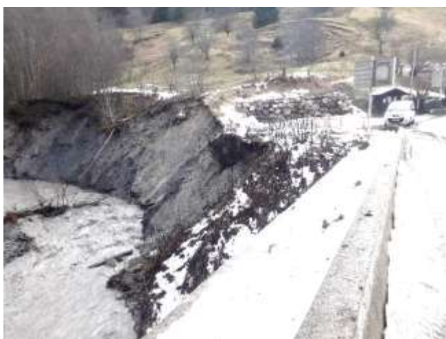
Glissement de terrain sur le Flon au droit du pont de la RD1212 à Saint Nicolas la Chapelle
