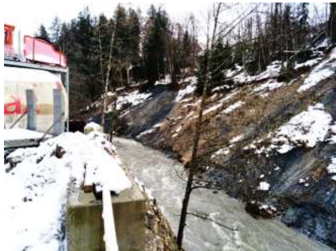
Glissement de terrain en rive gauche de l'Arly sur la ZA GEDIMAT à Flumet
