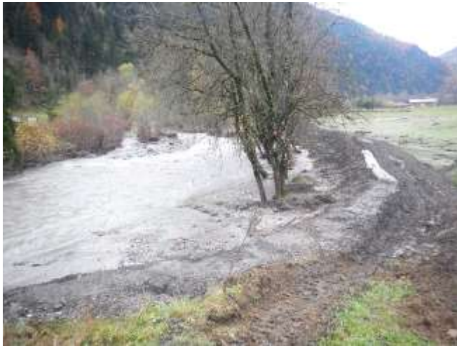
Exhaussement du Doron au niveau de la confluence avec le Dorinet – débordement dans la plaine. Travaux de confortement d'urgence par la commune de Beaufort et le SMBVA
