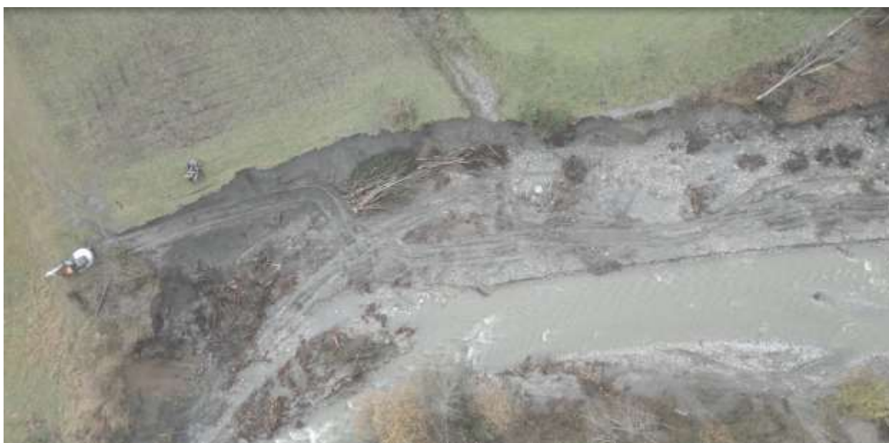
Erosion de berges de l'Arly en aval du Cassioz – le 20/11/23
