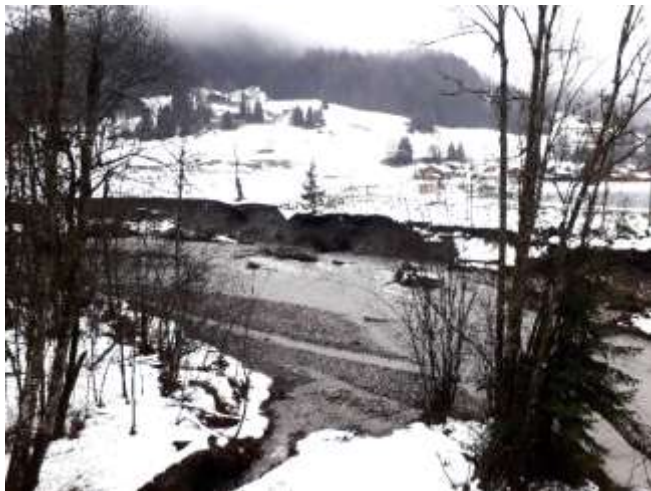
Aggravation des érosions de berges de l'Arly en aval de Cassioz, au droit magasins et plan d'eau de Praz sur Arly
