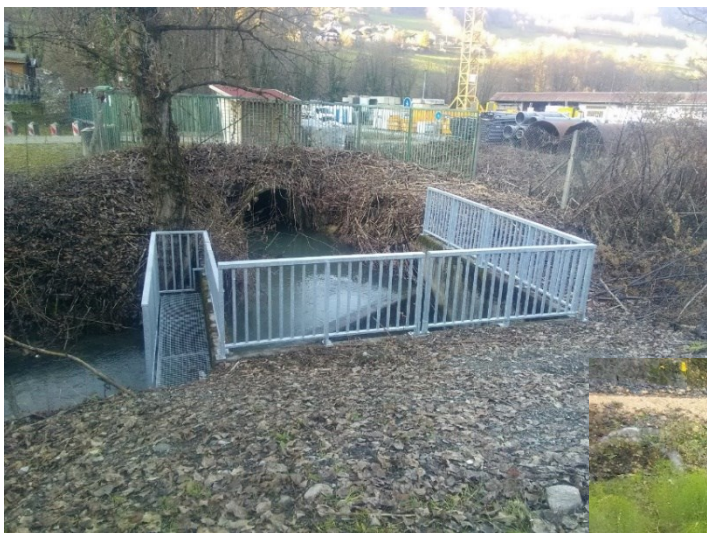
Mise en place de caillebotis et d'un garde corps au droit du déchargeoir de Bianco sur le canal Lallier
