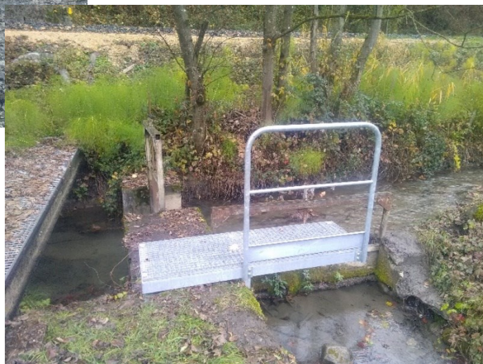
Mise en place de caillebotis et d'un garde corps au droit du déchargeoir de l'Isle sur le canal Lallier
