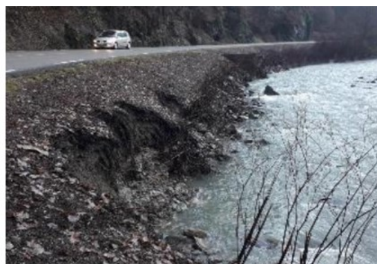
Doron : Erosion berge du Doron en rive droite, au droit du talus de la RD218 à la sortie de Queige |
