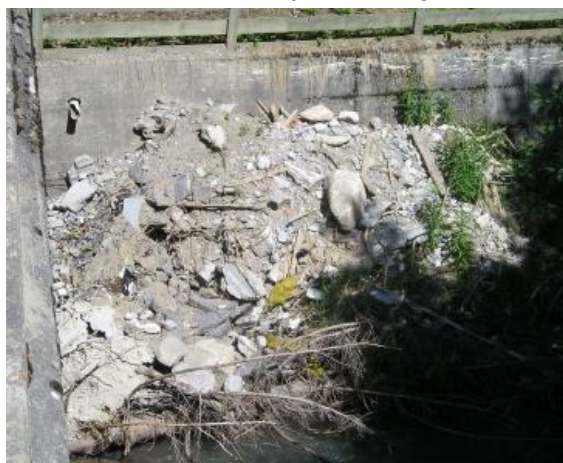
Dépôt tout venant dans un cours d'eau
